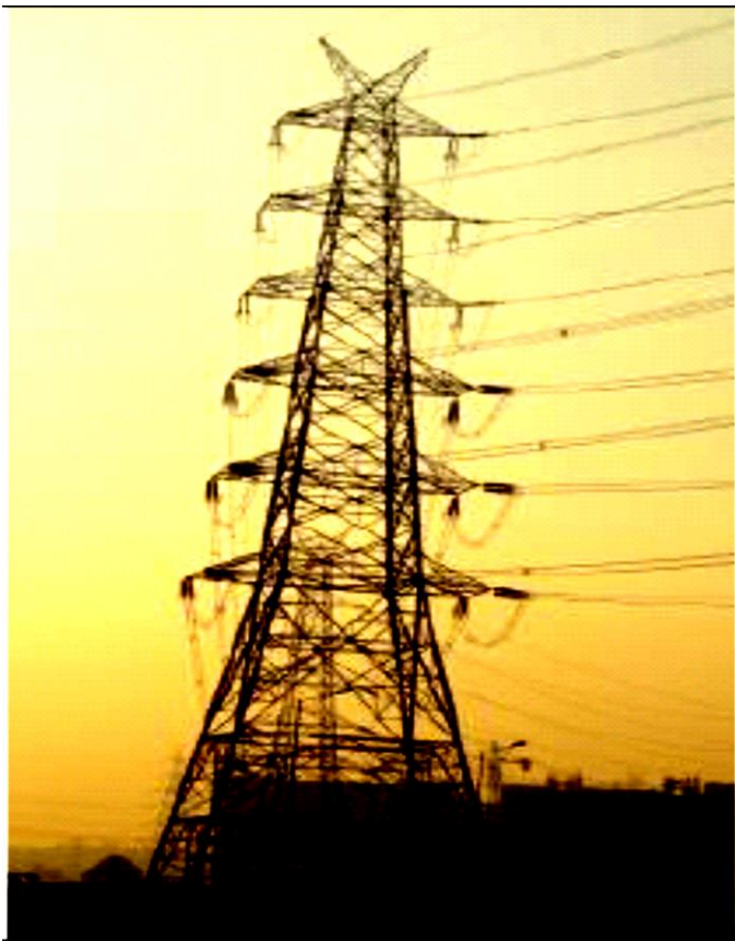
Рис.1. Опора четырёхцепной ВЛ 400 кВ (Индия)
